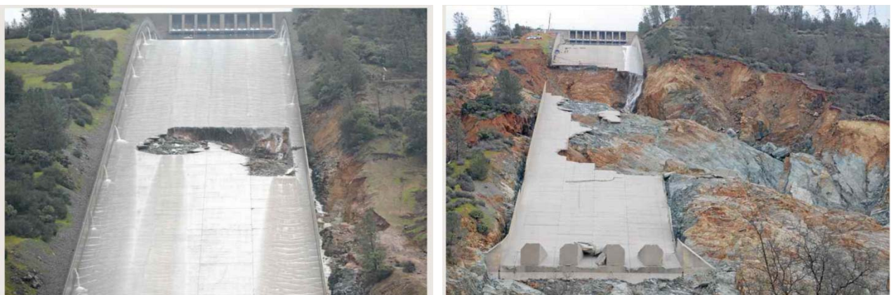
オロビルダム洪水吐きの損傷事故（発生直後 2017.2.8（左）、損傷拡大 3.9（右））
